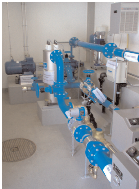
Das Herzstück: die Pumpturbine.
