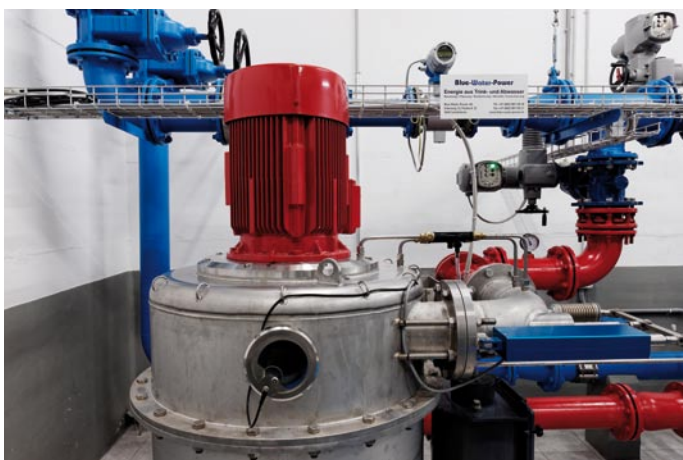
Von links fließt das Wasser vorerst via Trübungs- und Durchflussmesser sowie über Absperrschieber der Turbine zu. Alle Anlagenteile sind aus nichtrostendem Stahl hergestellt – Trinkwasser verpflichtet.
