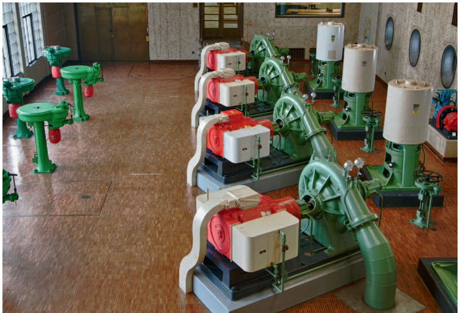
Trinkwasserpumpen sind der grösste Stromverbraucher im Gemeindebudget. Der Pumpencheck von InfraWatt zeigt Sparpotenziale auf.
