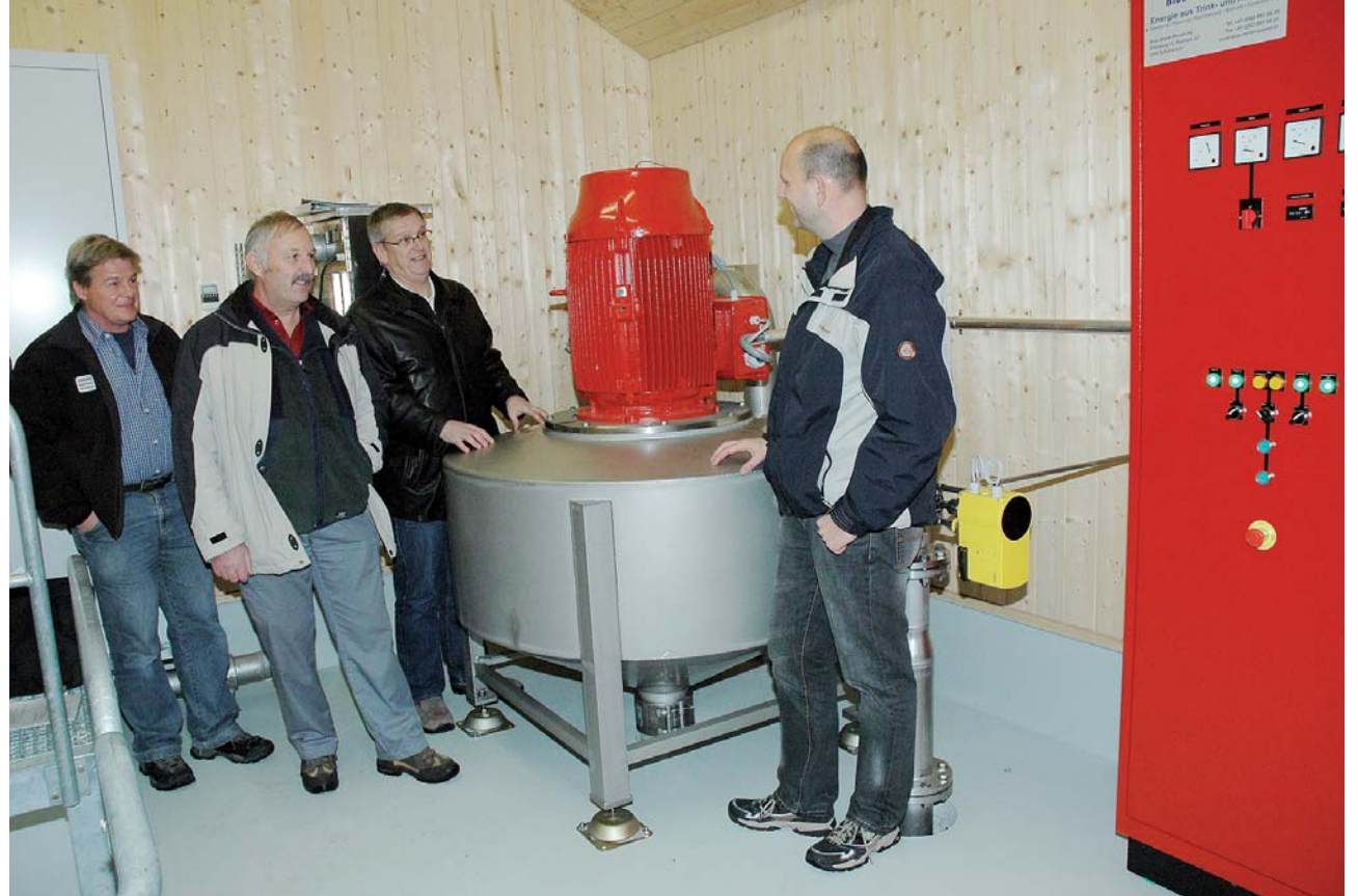
Strom aus Trinkwasser: Ulrich Kobel (rechts), erläutert Brunnenmeister Arthur Tobler, Fritz Looser, dem Präsidenten der Wasserversorgungskorporation, sowie Matthias Ensinger die Funktionsweise der Turbine. Rechts im Bild ist die vollautomatische Turbinensteuerung zu sehen.
